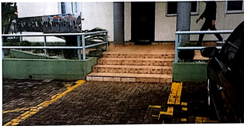
FOTO 02: ESCADA SEM CORRIMÃO ADEQUADO.
