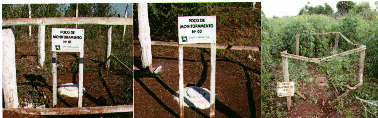
Figura 62 – Poços de monitoramento do aterro sanitário de Santa Terezinha de Itaipu.
