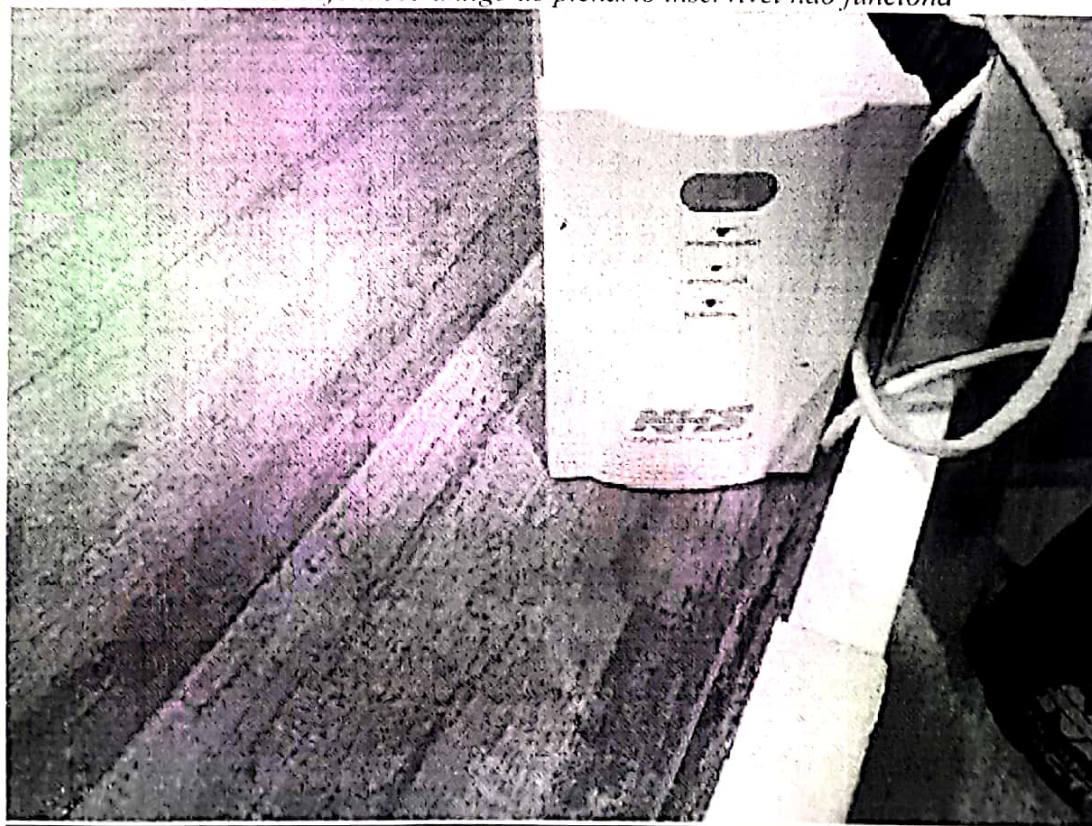
NOBREAK defeituoso antigo do plenário inservível não funciona
