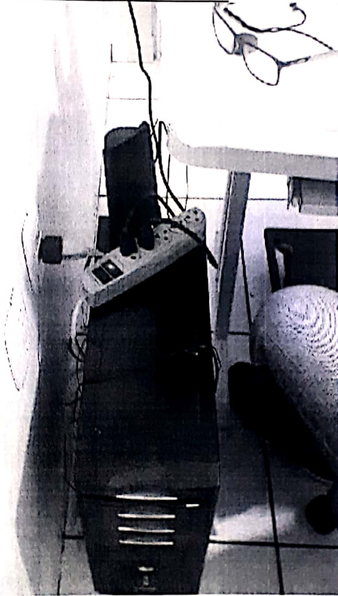
Computador 1 -Operando direto na régua de energia sem nobreak
